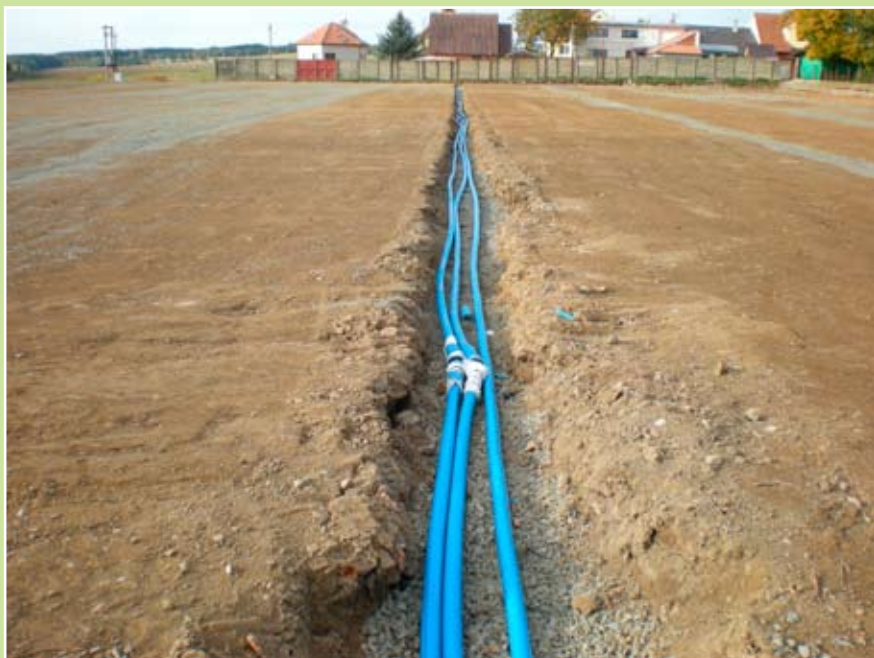
Rozvody závlahy, říjen 2008
